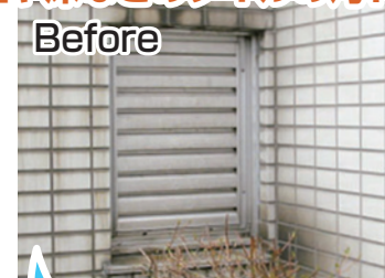
外壁タイルの汚れ
